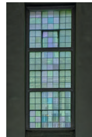
Eines der beiden renovierungsbedürftigen Fenster im Altarraum
